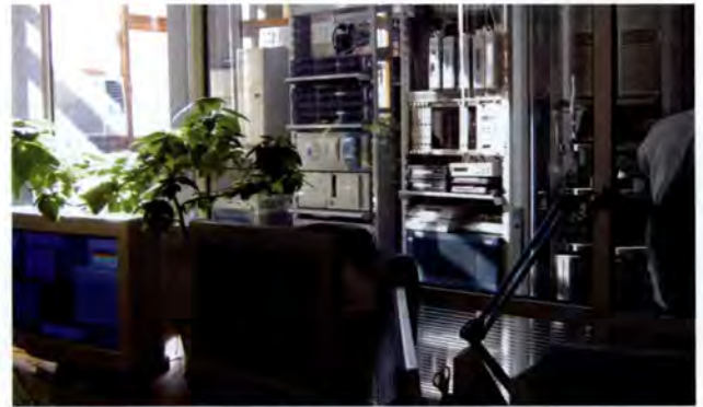
Оборудование сети передачи данных
