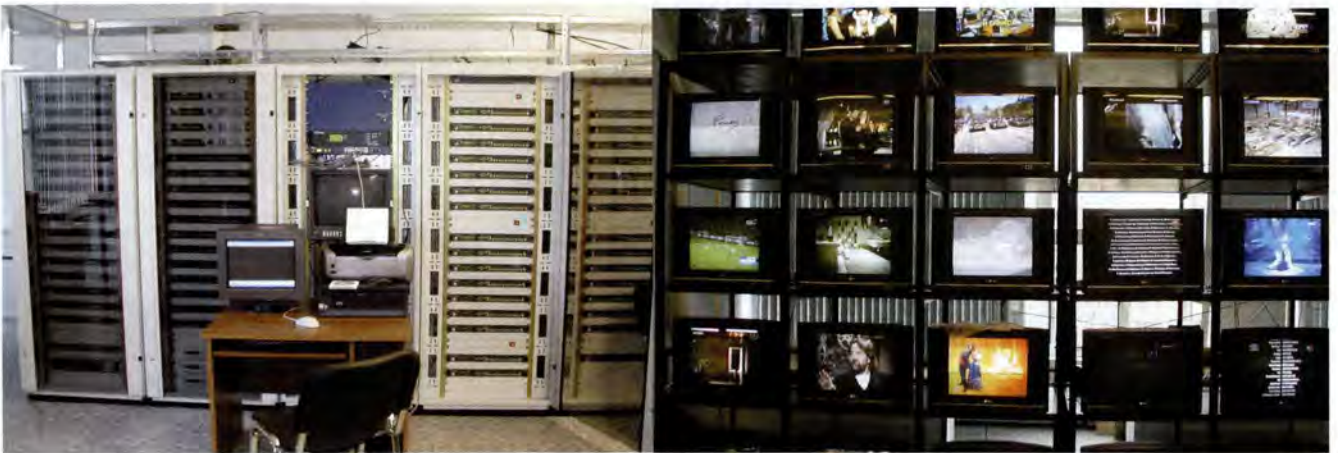
Оборудование кабельного телевидения
