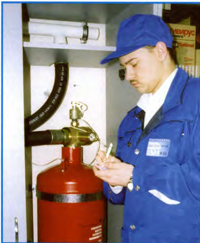
Проверка системы газового пожаротушения в серверной ОАО «ГИПРОСВЯЗЬ»
