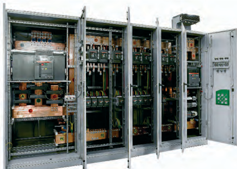
Главный распределительный щит низкого напряжения (0,4 кВ) на ток 5000 А
