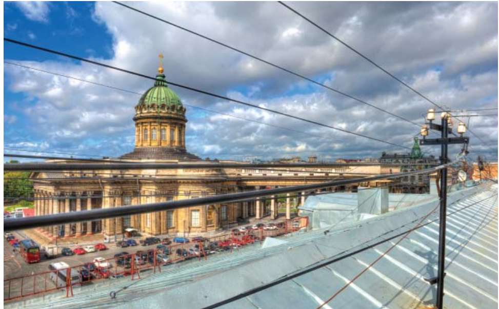
Трубостойка сети проводного вещания в районе Исаакиевского собора, г. Санкт-Петербург
