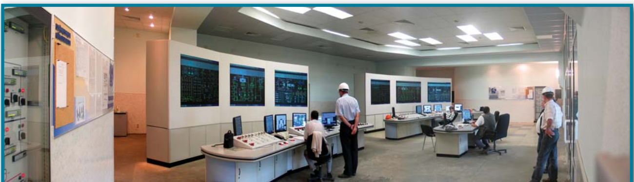
Рис. 1. Блочный щит управления Костромской ГРЭС
